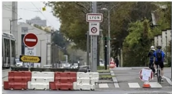
Depuis le 21 octobre, l'avenue Rockefeller (sens Bron-Lyon) est fermée à la circulation entre le bd Pinel et la rue Viala. Photo M. J.
